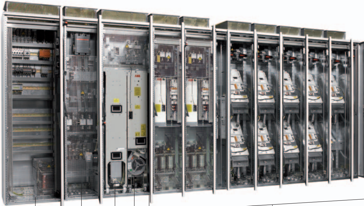
Hilfskomponentenschrank (ACU) Eingangsschrank (ICU) LCL-Filtermodul IGBT-Einspeiseeinheit Wechselrichtereinheiten
