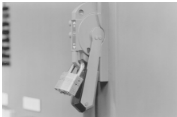
Strom abstellen und Bedienungselemente blockieren.
